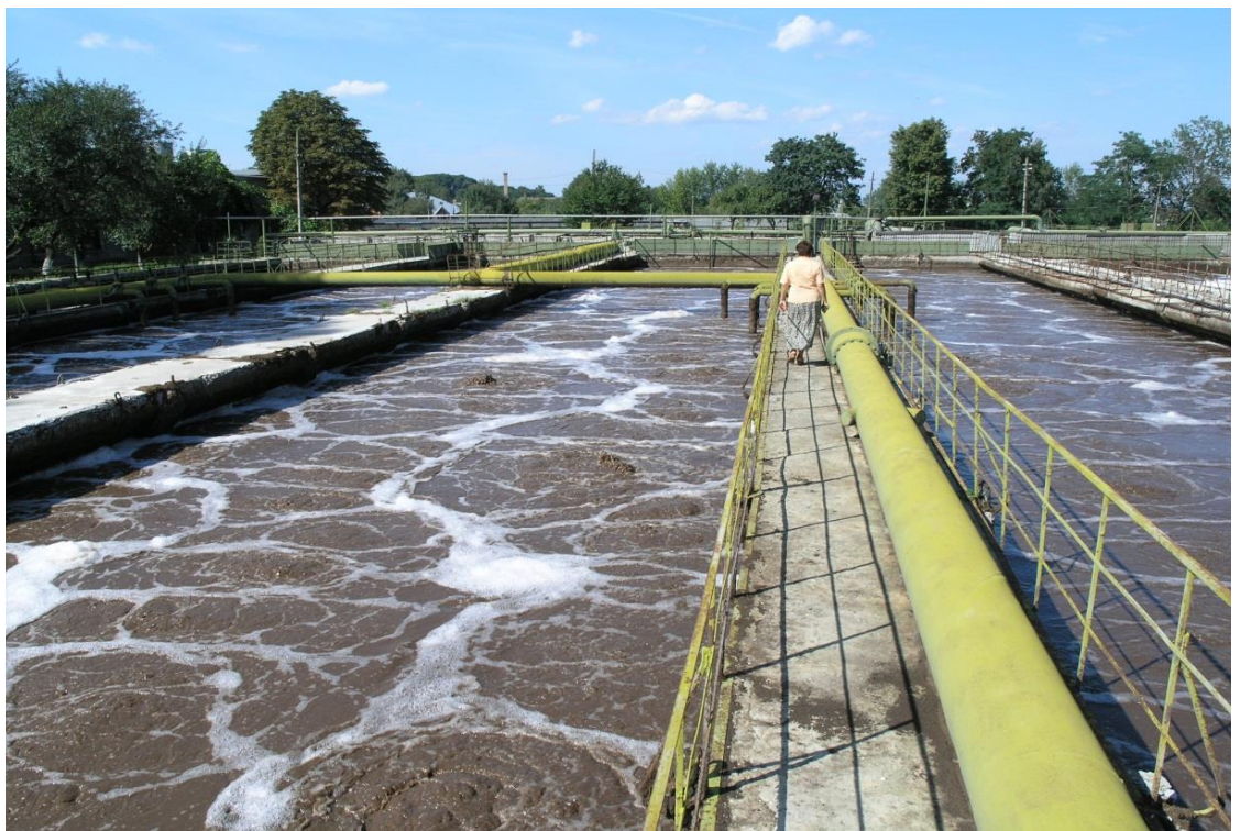
Рис. 4.4. Очисні споруди ЛМКП «Львівводоканал»
