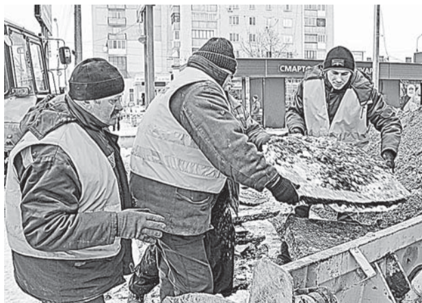
Порив на теплотрасі усувають оперативно.
