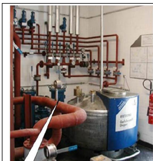
Рисунок 6.27. Насосна станція №2 з фільтром та контейнером для відходів очищення фільтра
