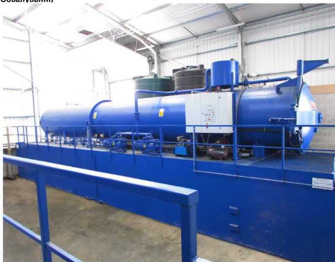
Завод для обробки, встановлений у первинній захисній системі уловлювання (Обвалуванні)
